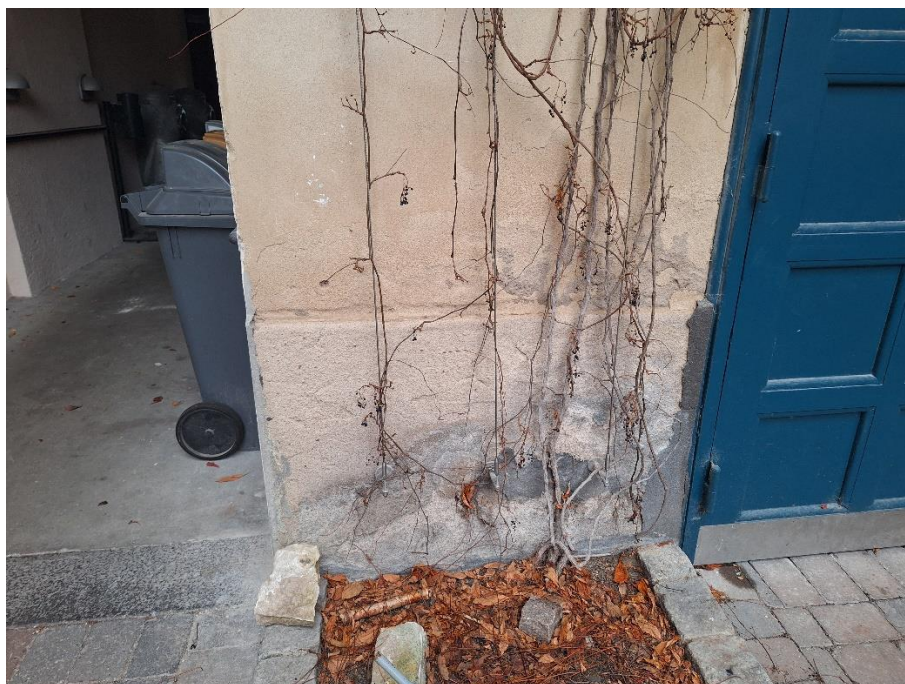
Underfacade i baggård nr. 2 – næsten alt puds er afskallet dette areal.
