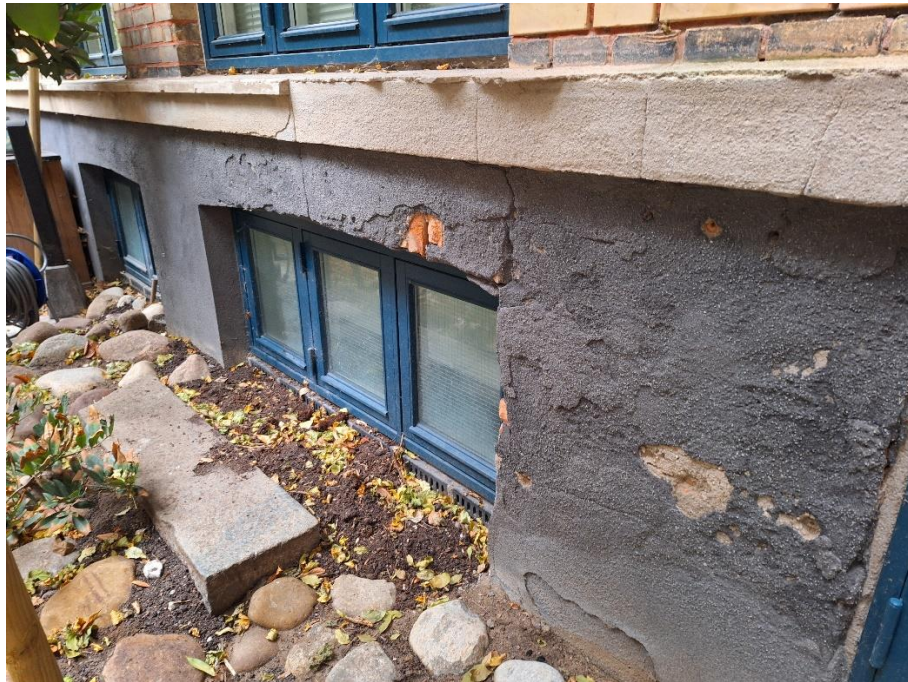
Underfacade i baggård nr. 8 – blotlagte mursten og frostsprængninger.
