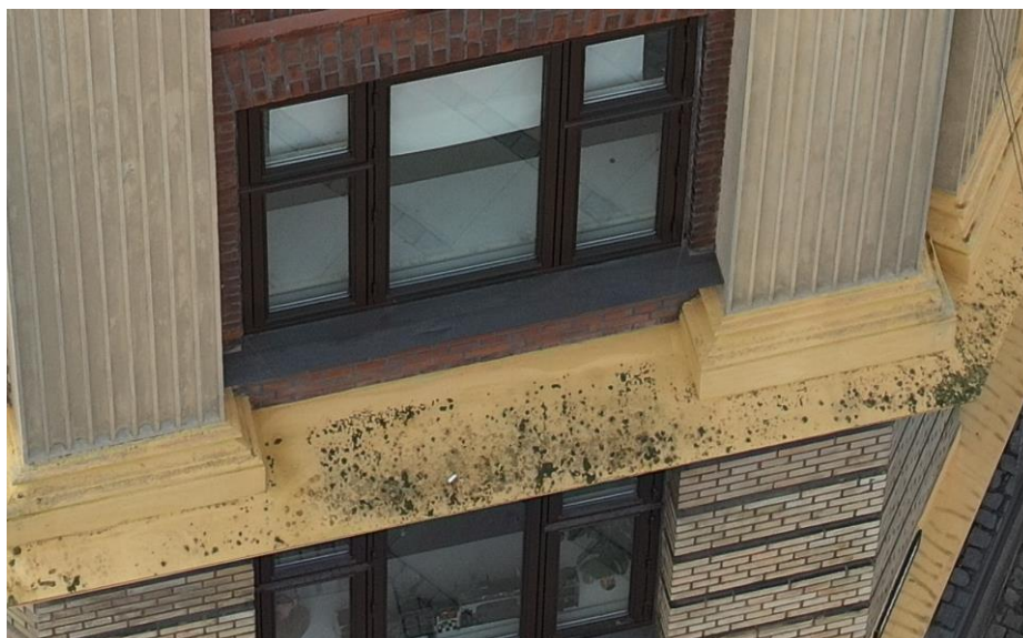
(eksempel på alger/begroninger på gesimsbånd 2)
