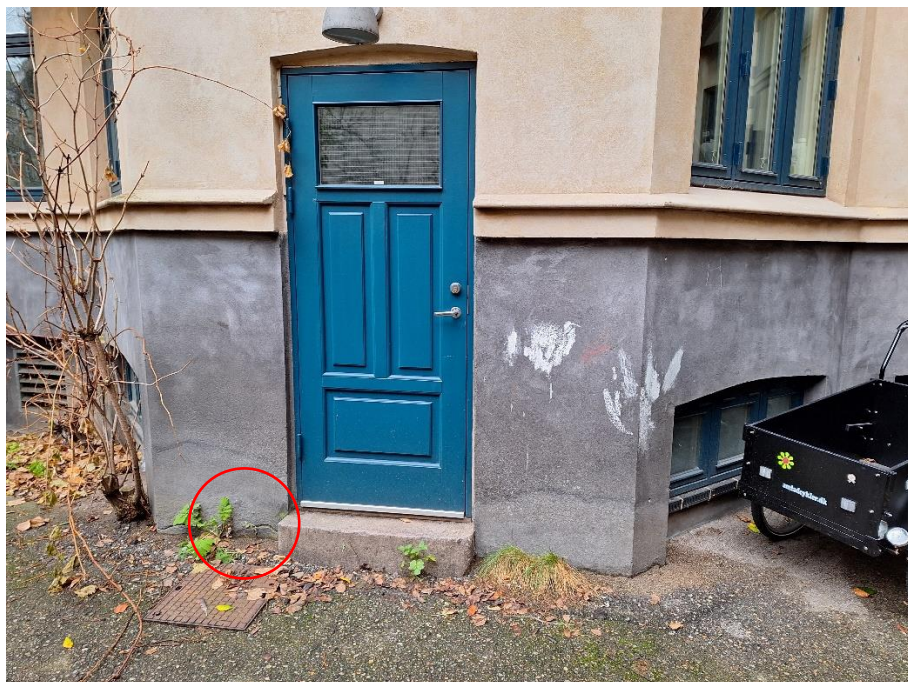
Underfacade i baggård nr. 5 – revne i underfacaden helt nede ved terræn
