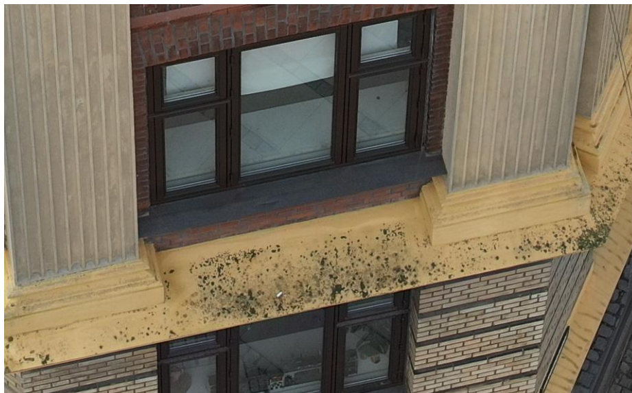
(eksempel på alger/begroninger på gesimsbånd 2)
