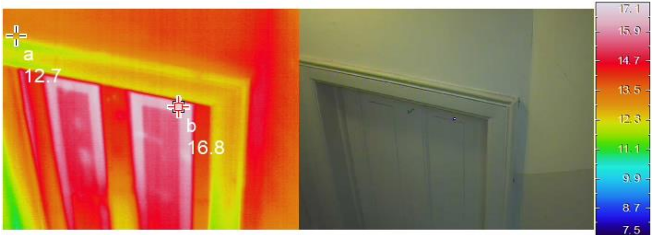
Termofoto nr. 08. + alm. foto – Bagtrappe 2 – Trappedør 3, (2.sal).
