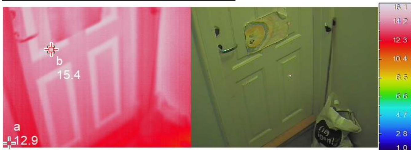
Termofoto nr. 05. + alm. foto – Bagtrappe 1 – Trappedør (4.sal).
